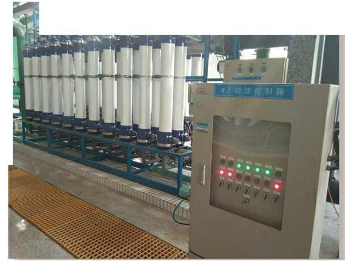
840 吨超纯水系统 840 ton ultra pure water system
