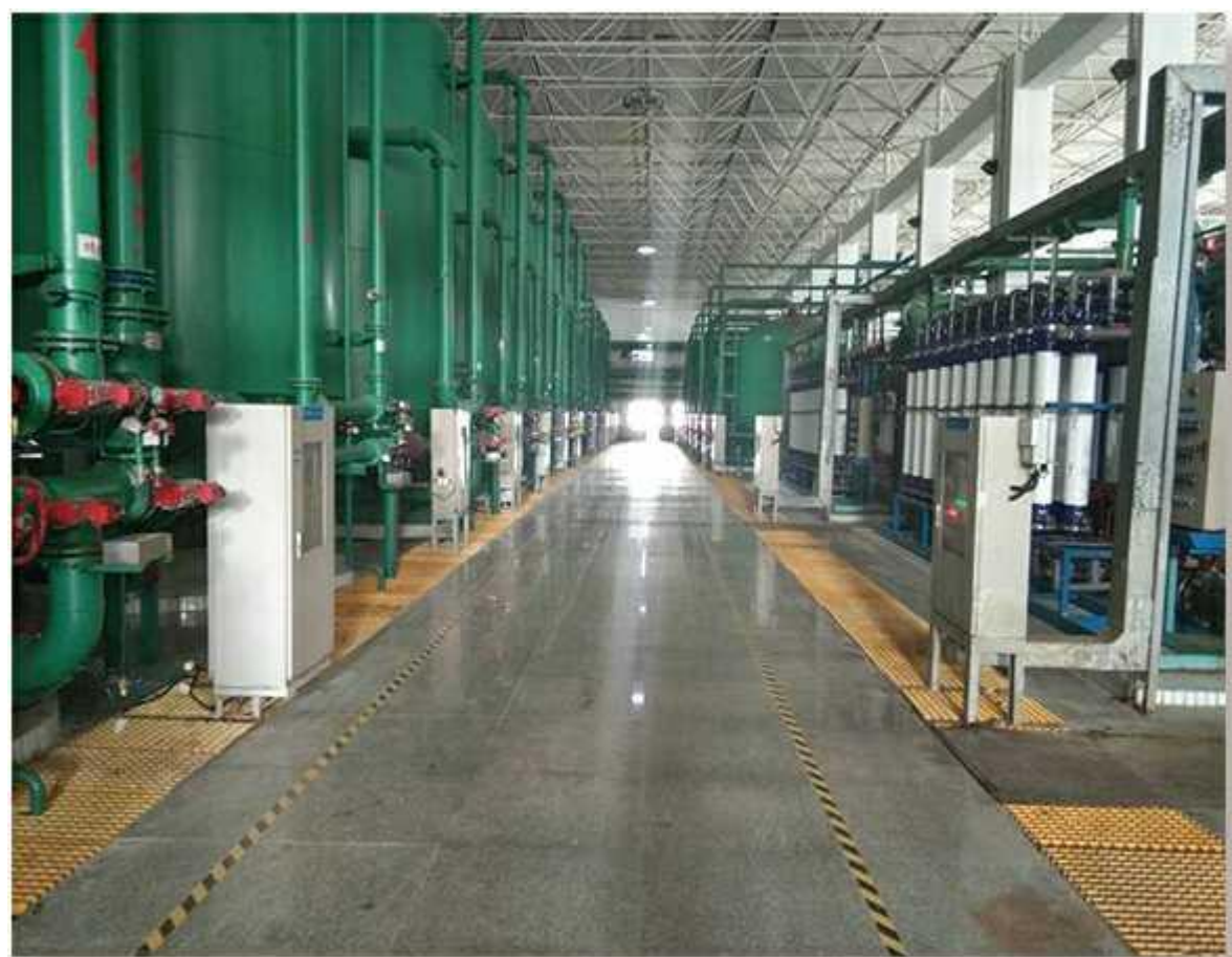
840 吨超纯水系统 840 ton ultra pure water system
