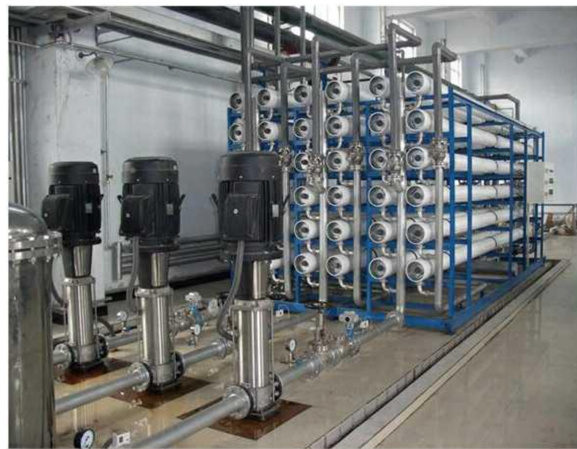
120 吨反渗透装置 120 ton reverse osmosis unit
