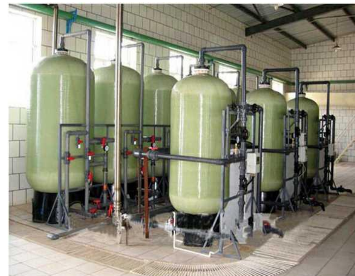
60 吨软化系统 60 ton softening system
