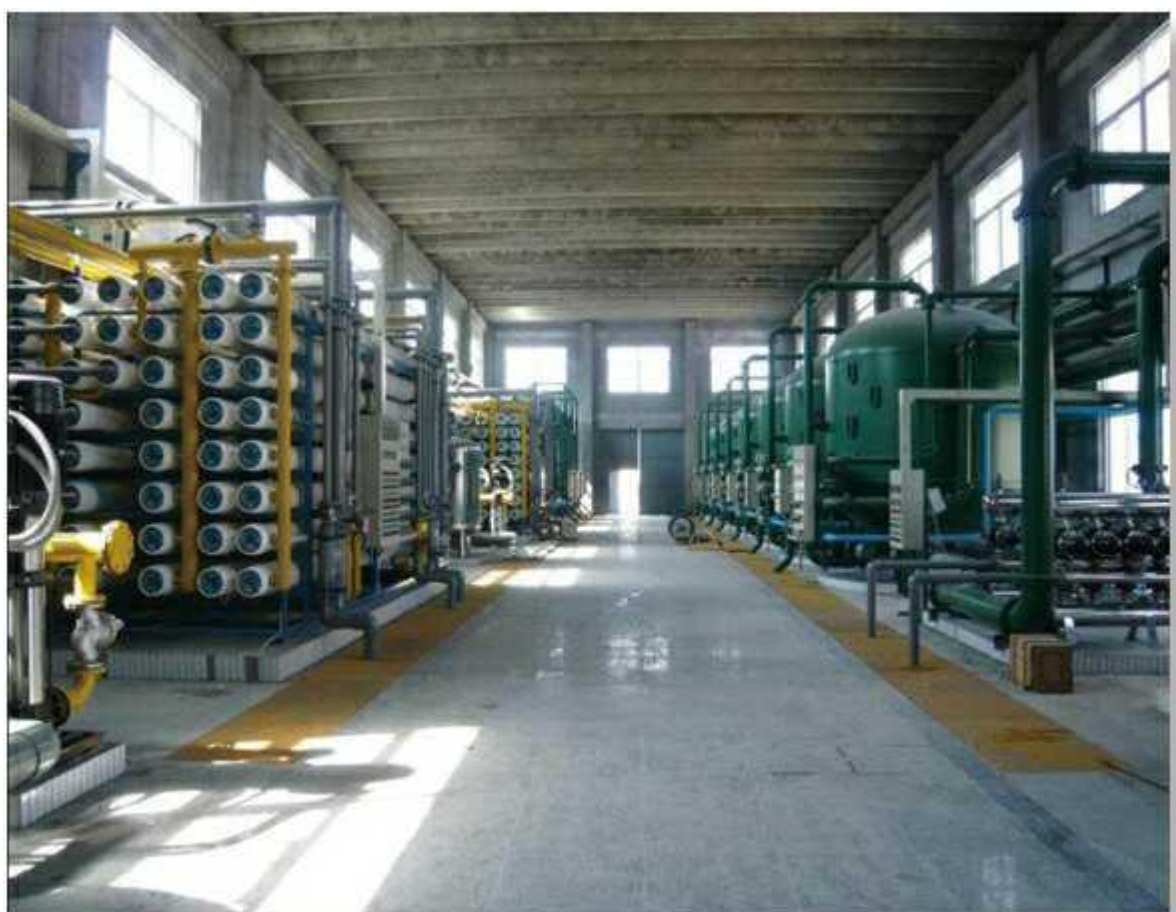
180 吨纯水系统 180 ton pure water system
