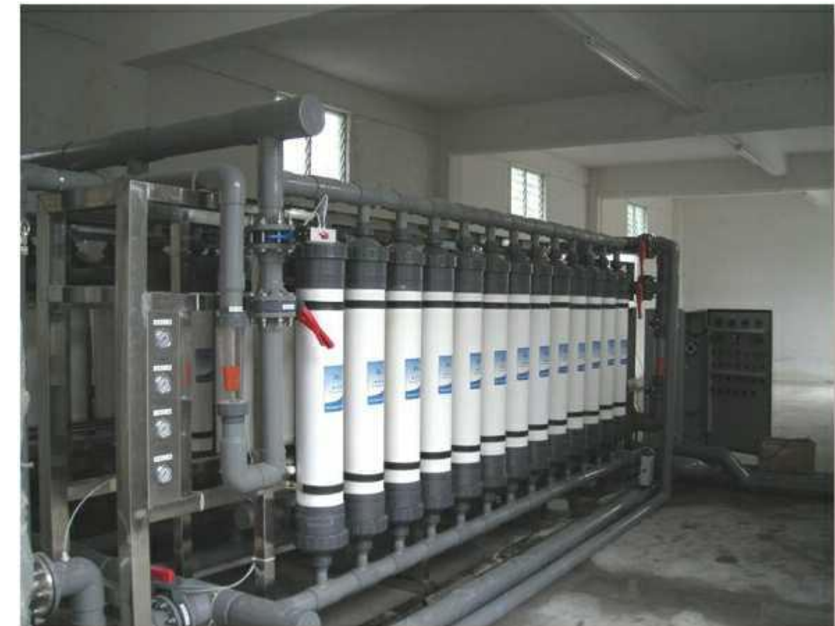
▶ 120 吨超滤装置 120 ton ultrafiltration unit
