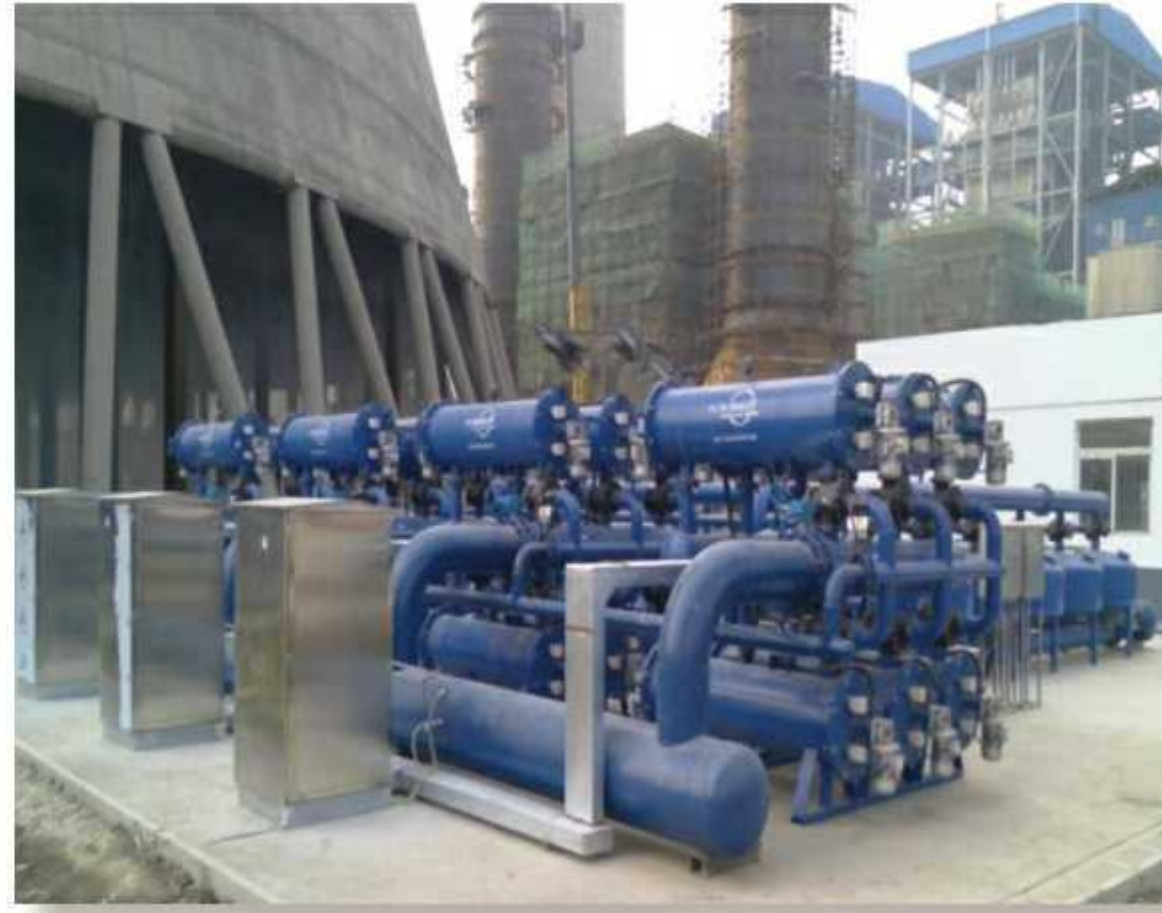
江苏某热电公司 A thermal power company in Jiangsu
